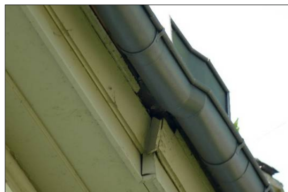
Abbildung 18: Spalten in der Dachverschalung
